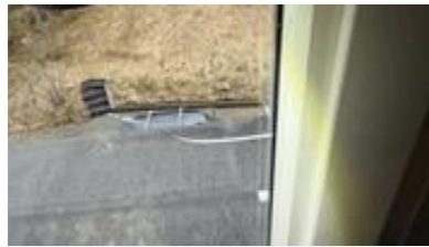
Eksempelbilde av sprekk i glass på soveromsvindu.
