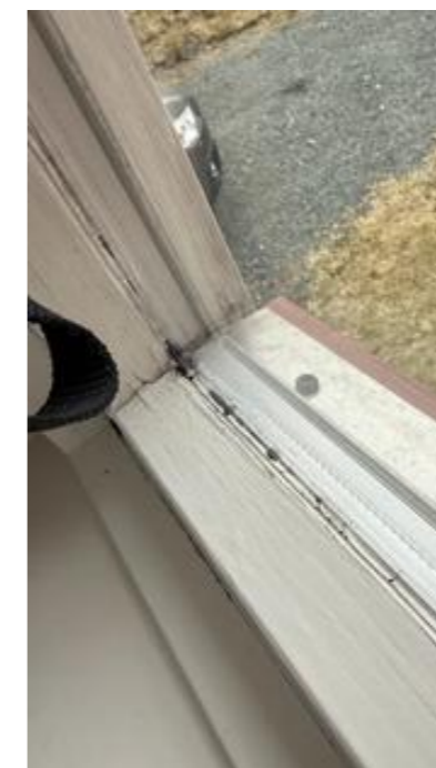
Eksempelbilde av slitasjegrad til vinduer i tilbygg.
