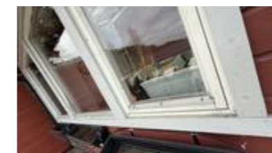
Eksempelbilde av slitasjegrad på vinduer ved terrasse med takoverbygg.
