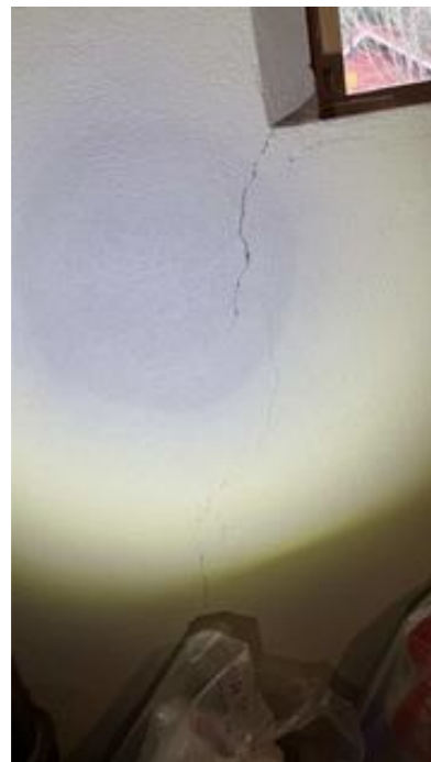
Eksempelbilde av riss/ sprekk i grunnmur.
