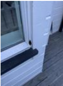
Råteskade ved hjørnet på et vindu i fasade sør, 1 etg
