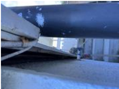
Det er ikke synlig gnagersikring / "musebånd" bak bordkledningen
