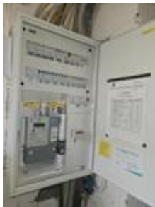
Sikringsskap med automatsikringer og kursfortegnelse, hoveddel
