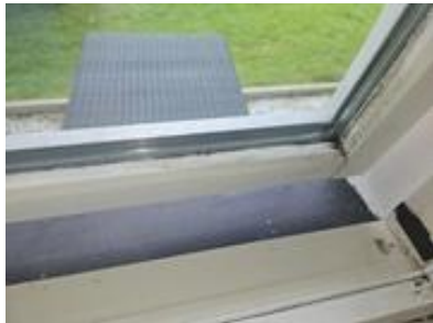
Sverte på vindusramme etter kondensering på glassruten
