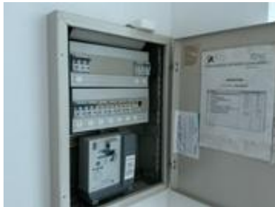
Sikringsskap med automatsikringer og kursfortegnelse, utleiedel
