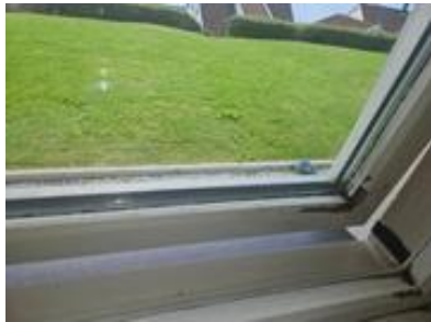
Sverte på vindusramme etter kondensering på glassruten
