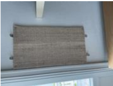
Montert "klørematte" for katt over kløremerker på tapeten på stuen
