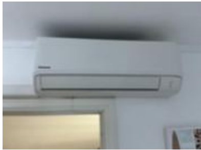
Luft til luft varmepumpe på loftet
