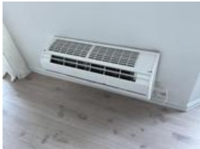
Luft til luft varmepumpe i stuen i 1 etg
