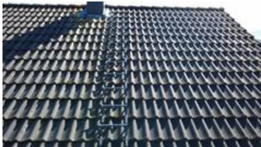
Fast monterte stigetrinn til pipen
