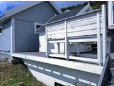
Terrasse av tre mot vest har ikke rekkverk
