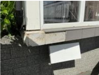
Løse fliser langs kanten av betongdekket foran hagestuen
