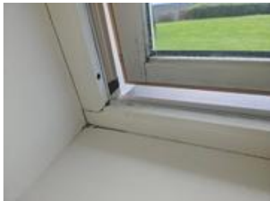
Sverte på vindusramme etter kondensering på glassruten
