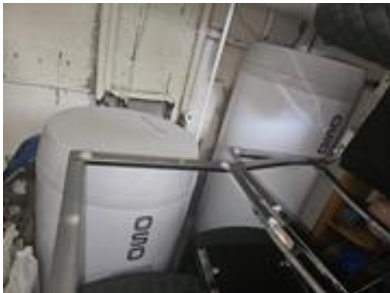
To nye varmtvannstanker i teknisk rom
