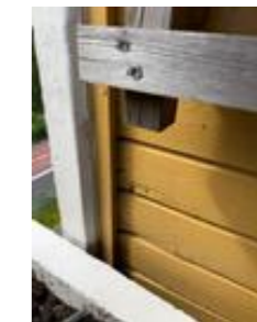
Tørråte i noen kleddningsbord på terrassebod.
