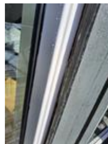
Utvendig listverk er ikke tilstrekkelig festet
