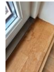
Fuktskjolder på terskel ved balkongdør
