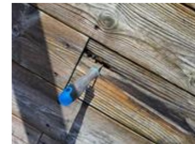
Råteskader i enkelte terrassebord
