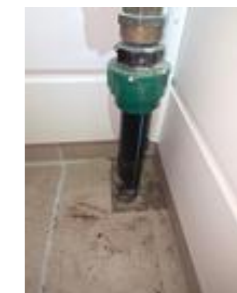
Det kan ikke konstateres membran rundt rørgjennomføringer i gulv.
