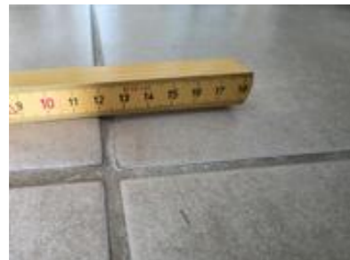
Ujevnheter på fliser i gang
