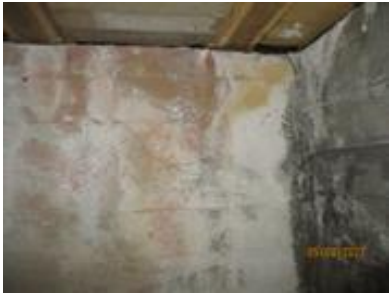
Saltutslag/fuger i vegger
