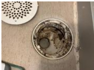
Plastsluk i gulvet
