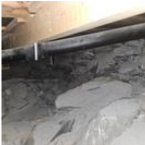
Avløpsrør av plast. Synlig i kjelleren
