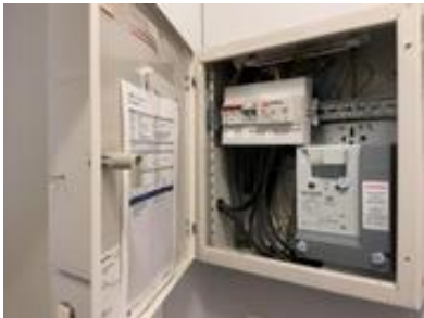
Sikringsskap med automatsikringer og kursfortegnelse
