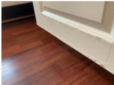
Fuktskade på dørblad bad "hybel - rom"
