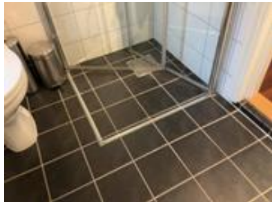
Badet fungerer til tross for lite fall, det er montert en tettelist rundt dusjnisen.
