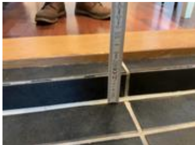
Oppkant foran døren for å hindre vann fra å renne ut fra badet
