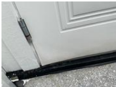
Begynnende fuktskade på nedre kant av dørbildet
