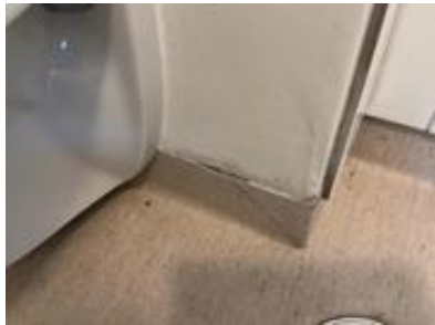
Utetthet i overgang gulvbelegg / vegg. Utenfor dusjen.
