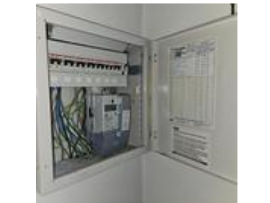
Sikringsskap med automatsikringer og kursfortegnelse
