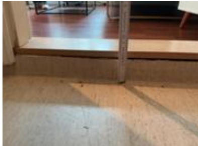
Det er en oppkant foran døren for å hindre vann fra å renne ut fra badet
