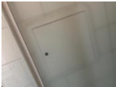
Fordelingsskap 1 etg øst. Vanskelig å åpne, bak dusjkabinettet
