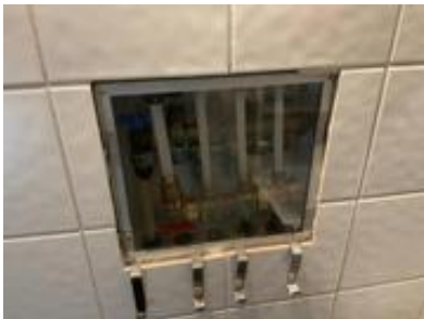
Fordelingsskap 2 etg øst
