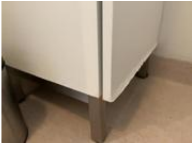
Fuktskade på kanten av servantskapet
