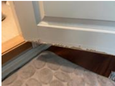
Fuktskade på dørblad bad 2 etg vest
