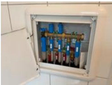
Fordelingsskap 1 etg vest
