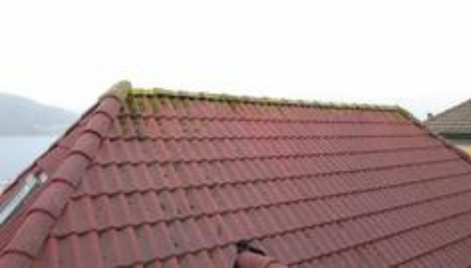
Takside nord. Litt mose ved langs og ved mønet
