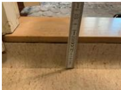
Gulvbelegget er brettet opp foran dørstokken for å hindre vann fra å renne ut fra badet
