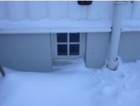
Et eldre kjellervindu som ikke er skiftet.
