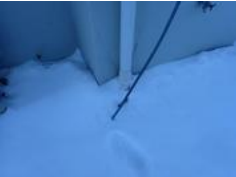
Taknedløp er glidd ut av skjøt, taknedløp er lokalisert mot østsiden av boligen.
