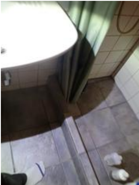
Forhøyning i dusjonen som hindrer lekkasjevann utenfor dusjsonen å nå sluk.
