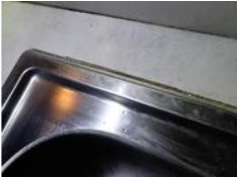
Fuktskade/svelling i benkeplate ved servant.
