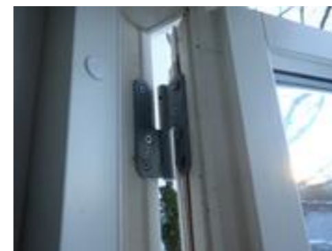
Innfesting til hengslene er løs som følger av skader i karmen.
