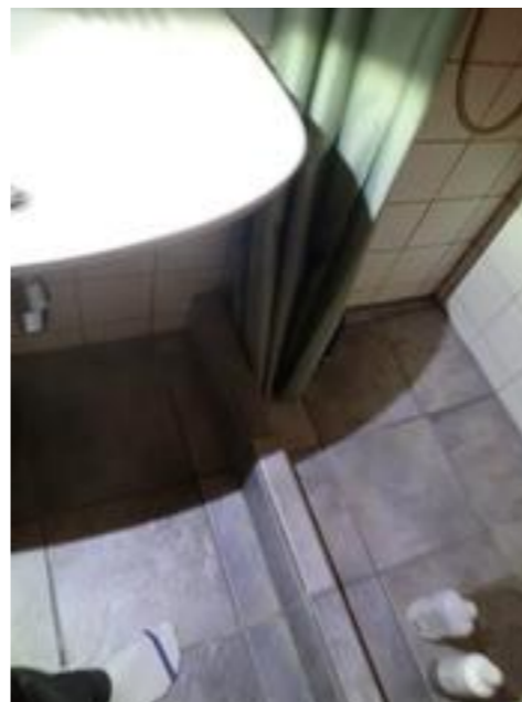
Forhøyning i dusjsonen som hindrer lekkasjevann utenfor dusjsonen å nå sluk.
