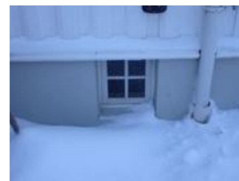
Et eldre kjellervindu som ikke er skiftet.
