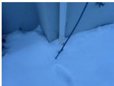
Taknedløp er glidd ut av skjot, taknedløp er lokalisert mot østsiden av boligen.
