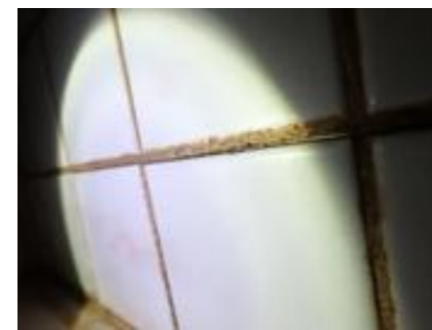
Eksempel på riss/sprekk i vegg i dusjsonen
