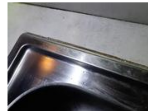
Fuktskade/svelling i benkeplate ved servant.
