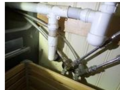
Bruk av uegnede materialer (panelplater) i våtsonen bak servant.
