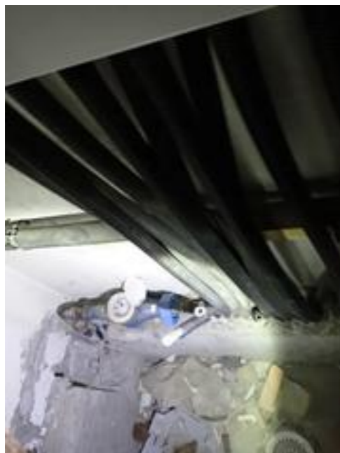
Avrenning fra rørfordelingsskap ledes til gulv med sluk, men det er ikke tilfredsstillende tettesjikt på gulv med risiko for følgeskader ved lekkasje fra rør i rør.
