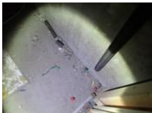
Avrenning fra rørfordelingsskap ledes til gulv med sluk, men det er ikke tilfredsstillende tettesjikt på gulv med risiko for følgeskader ved lekkasje fra rør i rør.
