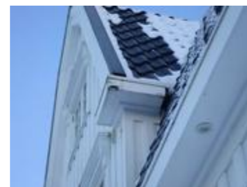
Lokal råteskade/værslitasje på treverk, det er tilsvarerne på motsatt side av takutstikket.
