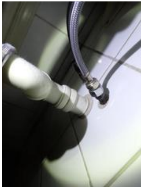
Ikke synlig tettesjikt på rørgjennomføringer i vegg under servant.
