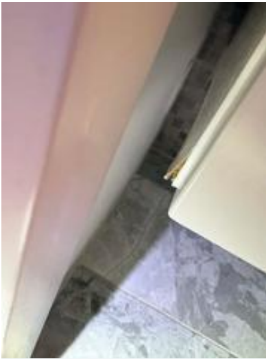
Eksempel på svelling/fuktskade på innredning som følger av vannsøl.
