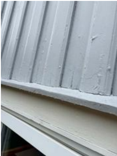
Eksempel på stedvis værslitt/oppsprukket panel.
