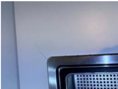
Sprekk skade på benkeplate ved servant.
