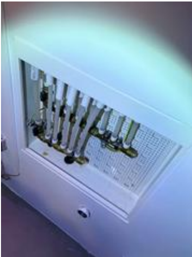
Avrenning fra rørfordelingsskap i kjeller ledes til rom uten sluk.
