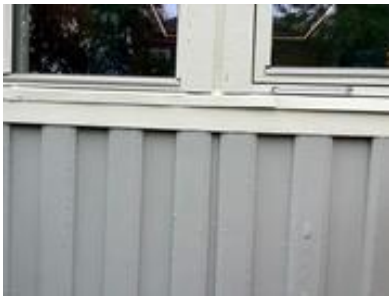
Eksempel på stedvis blæring i maling.
