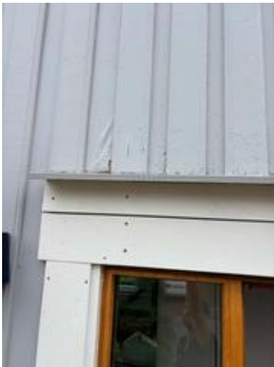
Eksempel på stedvis værslitt/oppsprukket panel og blæring i maling.
