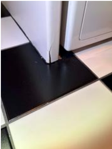
Skade/svelling på dekkside/benkeplate mot gulv ved vaskemaskin.
