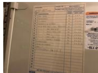
Utstyr for varsling og slukking av brann
