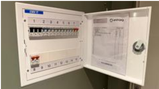
Bildet viser sikringskapet for det elektriske anlegget.
