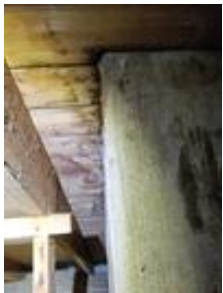
Fuktskjolder/skader ved pipegjennomføring
