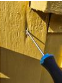
Spredt råteskader i bordkledning
