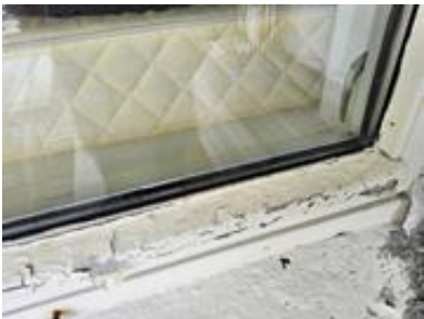
Værslitasje på beslag
