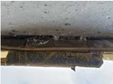
Ingen/liten lufting i nedre kant av konstruksjon.
