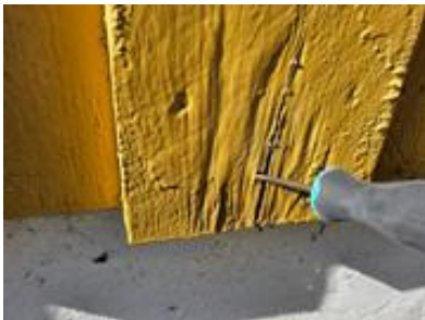
Spredt råteskader i bordkledning
