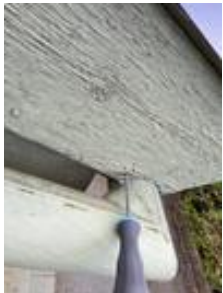
Mindre fukt/råteskader i vindski
