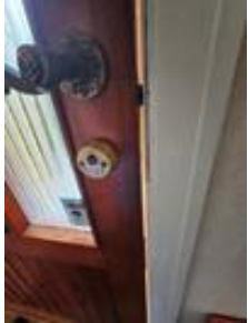
Utett mellom dørblad og karm hovedytterdør
