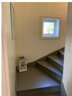
Trapp mellom 1 og 2.etasje mangler håndløper på vegg.
