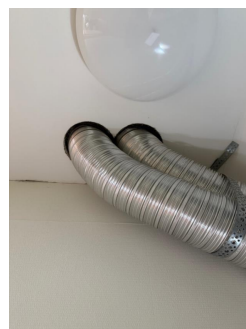
Ufullstendig dampsperre rundt gjennomføring
