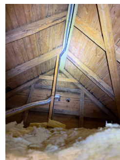
Ventilasjonsrør med manglende kondensisolering
