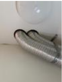
Ufullstendig dampsperre rundt gjennomføring
