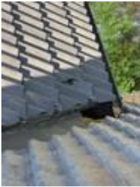
Knekt/knust takstein ved gradrenne på nordlig ark
