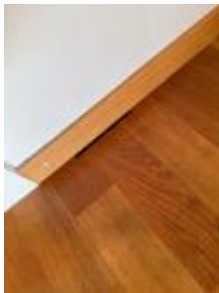
Unøyaktig avslutning av parkett i stue like ved kjøkken. Se også egen rubrikk for Kjøkken
