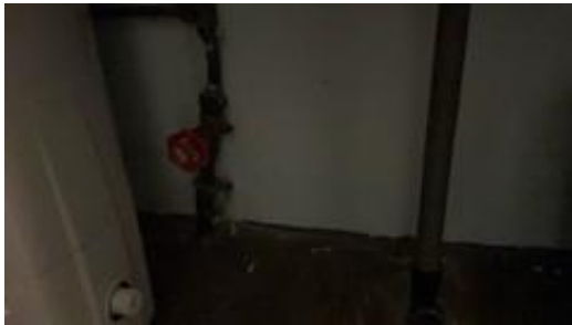
Stengekran plassert på vaskerom.
