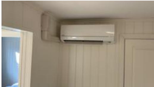
Varmepumpe montert i hall i 1 etg.
