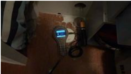
Fuktmåling i svill ga ingen utslag.
