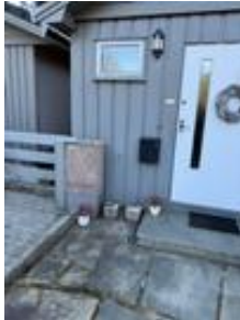
Utvendig spylekran ved inngangsparti. (ikke funksjonstestet)
