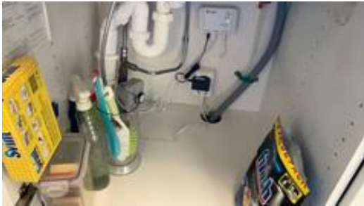
Vannstoppsystem med sensor i benkeskap under vask.
