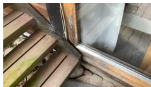
Værslitt skyvedør i underetasje.
