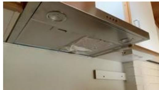
Ventilator funksjonstestet med papir.
