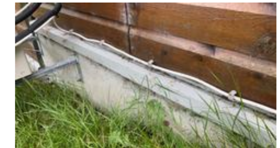
Lite eller ingen tiluftsspalte mellom nedre bordkledning og her beslag/terreng
