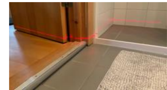
Terskeloppbrett på dør er lavere enn dusjprofil på gulv.
