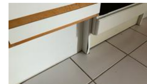
Fuktskadet sidevegg kjøkkeninnredning.
