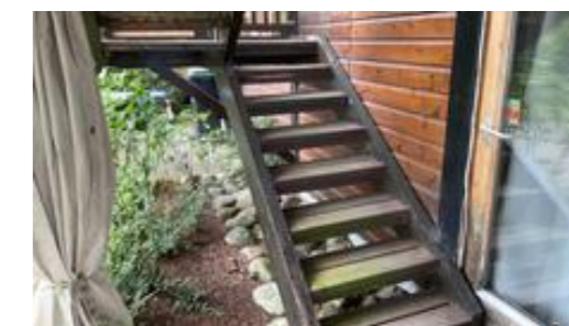
Ikke montert rekkverk på deler av trapp.
