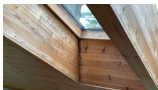
Mye fuktmerker på utforingspanel etter kondensering/evt fukt.
