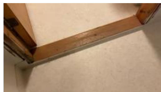
Ingen beskyttelse på terskeloppbrett.
