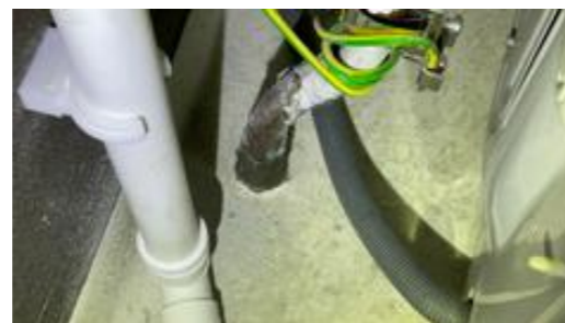
Ingen mansjett/oppbrett på rørstammen.
