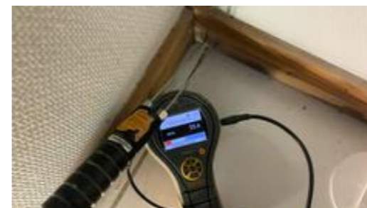
Synlige fuktmerker/blåmann i fotlist, for høy trefukt.
