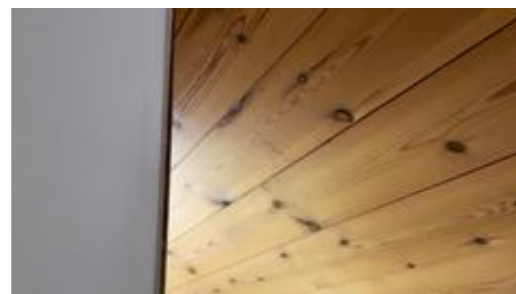
Fuktmerke i panel nedenfor pipe.
