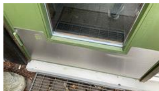
Værslitte deler på ytterdør.
