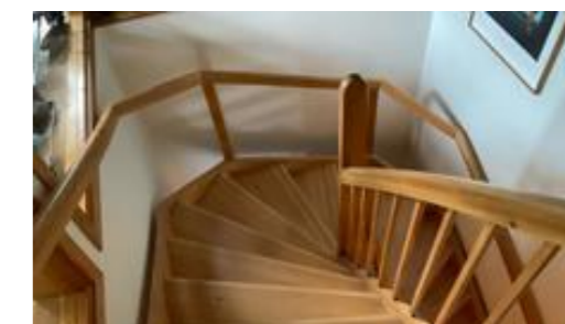
Trapp inne, store åpninger i rekkverket.
