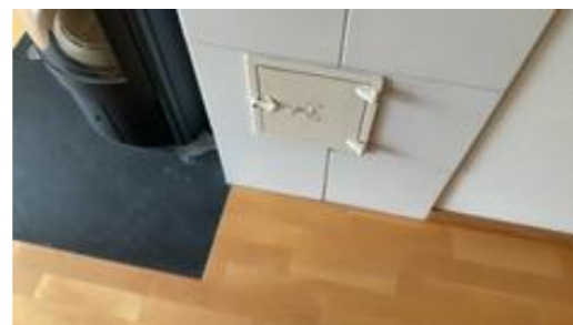
Ingen ubrennbar plate på gulv under feieluke.
