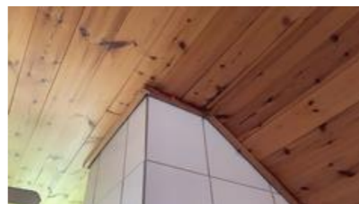
Enkelte tørre fuktmerker i panel/tak mot pipe.
