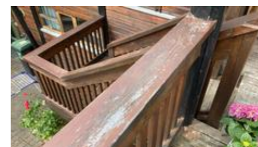
Værslitte overflater på rekkverk/rekke.
