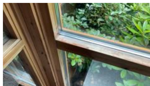
Avflassing/kondensmerker på innside ramme/karm.
