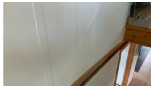
Fukttenner på vegg ved pipe.
