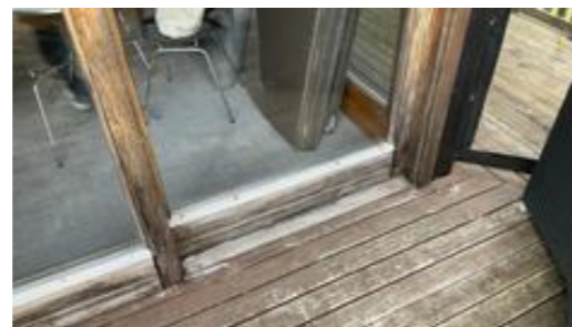
Værslitt skyvedør i innglasset balkong
