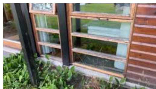
Enkelte værslitte ute på ramme/karm.
