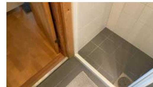
Dør plassert i dusjens fuktzone.
