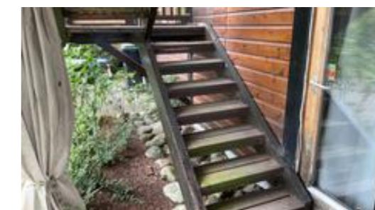
Ikke montert rekkverk på deler av trapp.
