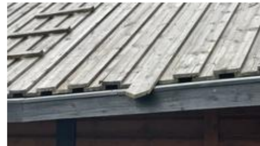
Enkelte sprekker takbord.
