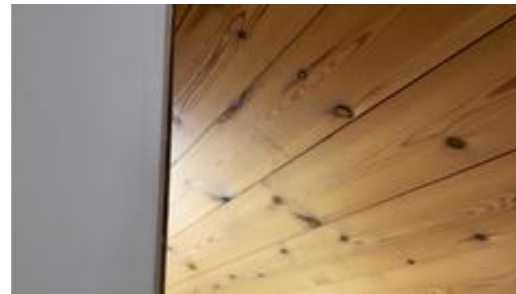
Fuktmerke i panel nedenfor pipe.
