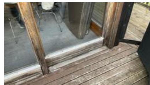
Værslitt skyvedør i innglasset balkong
