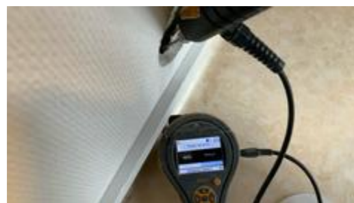
Hulltatt/fuktsøkt i vegg på vaskerommet uten unormale forhold.
