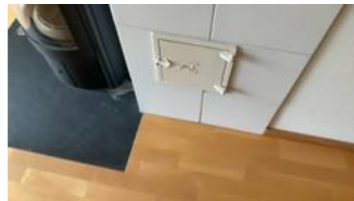
Ingen ubrennbar plate på gulv under feieluke.
