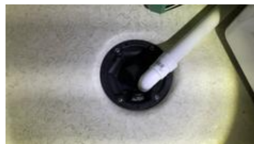
Sluk i gulv.
