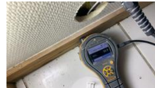
Ingen unormale fuktforhold i påforet yttervegg på ett bestemt sted.
