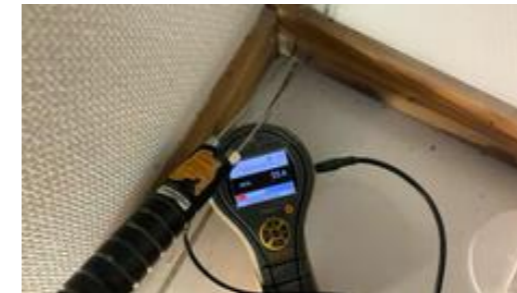
Synlige fuktmerker/blåmann i fotlist, for høy trefukt.
