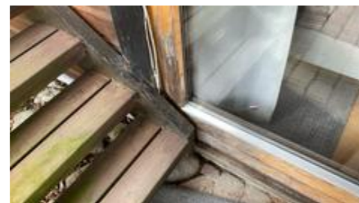
Værslitt skyvedør i underetasje.
