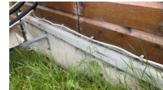
Lite eller ingen tiluftsspalte mellom nedre bordkledning og her beslag/terreng
