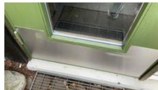
Værslitte deler på ytterdør.
