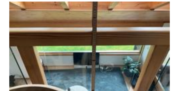
avere rekkverk enn 90 cm på loft/hems.
