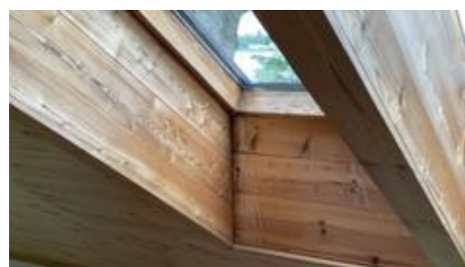
Mye fuktmerker på utforingspanel etter kondensering/evt fukt.
