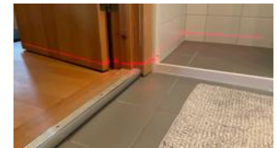
Terskeloppbrett på dør er lavere enn dusjprofil på gulv.
