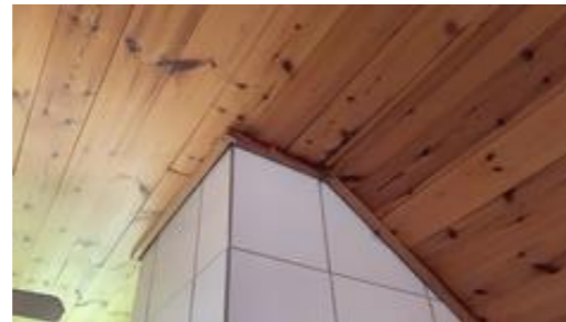
Enkelte tørre fuktmerker i panel/tak mot pipe.
