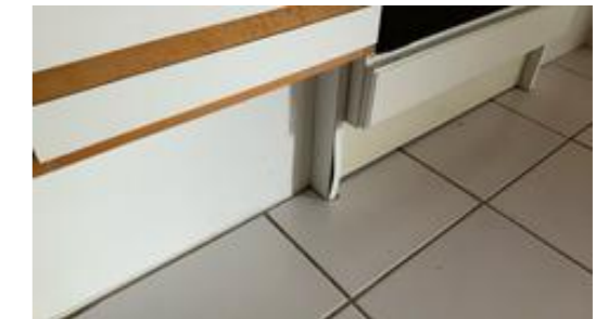
Fuktskadet sidevegg kjøkkeninnredning.
