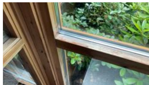
Avflassing/kondensmerker på innside ramme/karm.
