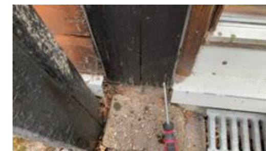
Råteskader på nedre del av synlige vegg søyler.
