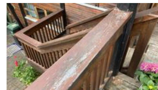
Værslitte overflater på rekkverk/rekke.
