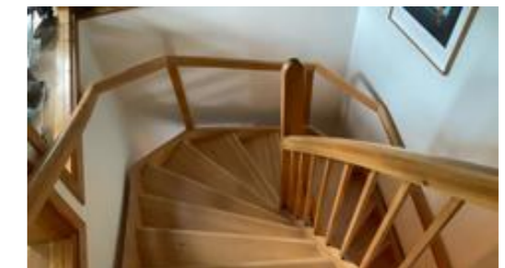
Trapp inne, store åpninger i rekkverket.
