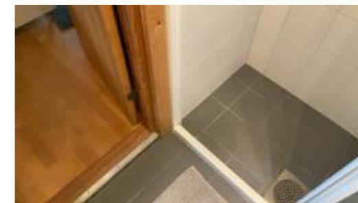
Dør plassert i dusjens fuktzone.
