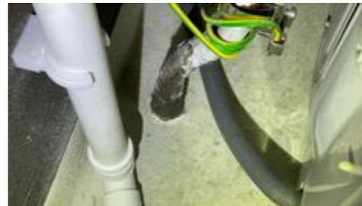
Ingen mansjett/oppbrett på rørstammen.
