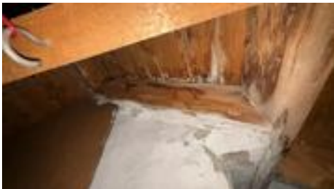
Bilde av eldre fuktskjolder rundt pipe på kaldloft.
