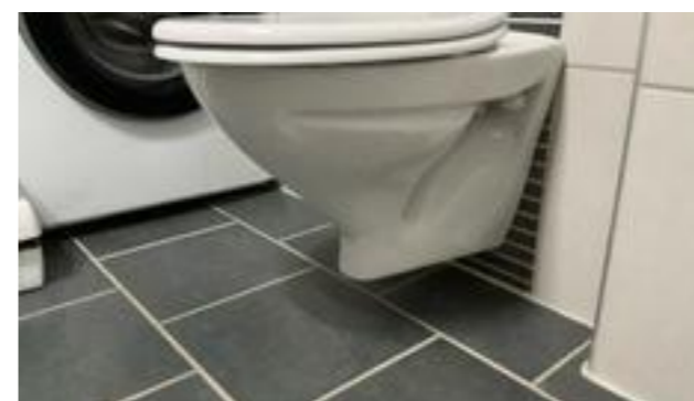
Det er ikke dreneringsåpning fra innebygde toilettslaktere
