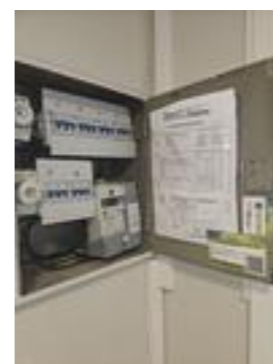
Sikringskapp med automatsikringer og kursfortegnelse
