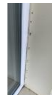
Det er ikke tett mellom vinduskarmen og omramming
