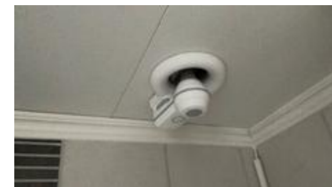
Mekanisk avtrekk fra badet
