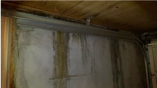
Eldre fuktrenner på mur i garasje.
