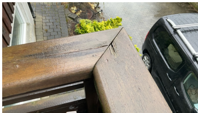
Oppsprikning av rekke.
