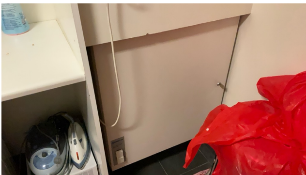
Motor for ventilasjonsanlegget
