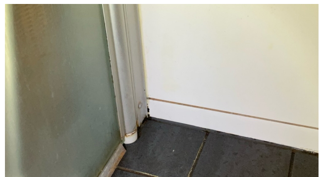
Misfarging i flisefuger, svertesopp på overflater.
