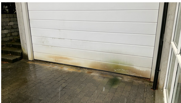
Misfarging/rustfarge på nedre del av garasjeport.
