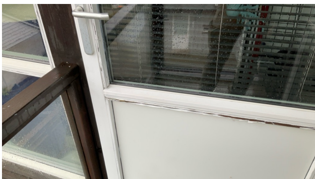
Malingsavflassing på overflater balkongdører.
