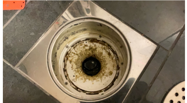
Sluk i gulv.
