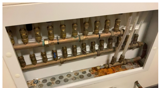
Vannledninger av plast
