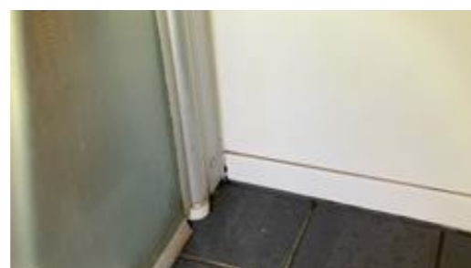
Misfarging i flisefuger, svertesopp på overflater.
