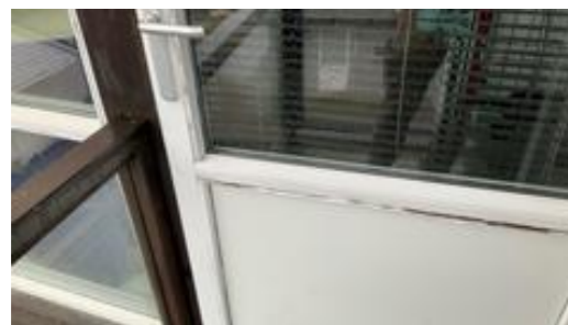
Malingsavflassing på overflater balkongdører.
