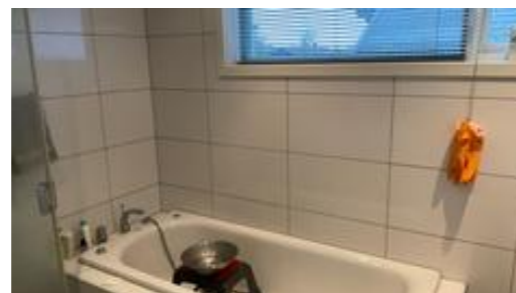
Vindu plassert i badekarets fuktzone.
