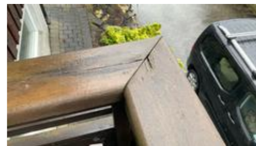
Oppsprikking av rekke.
