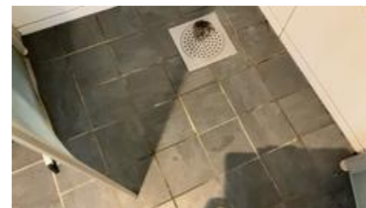
Misfarging/kalkmerker på overflater i dusj.
