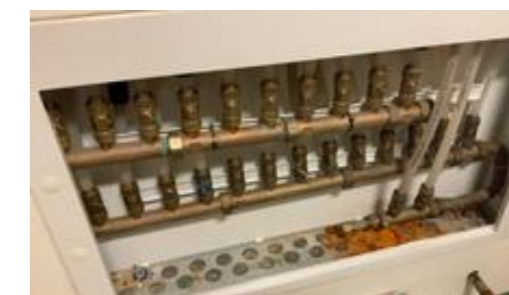
Vannledninger av plast
