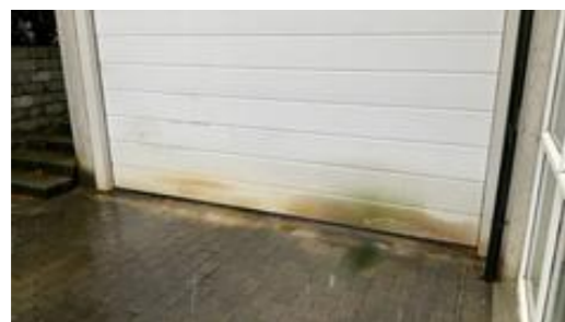
Misfarging/rustfarge på nedre del av garasjeport.
