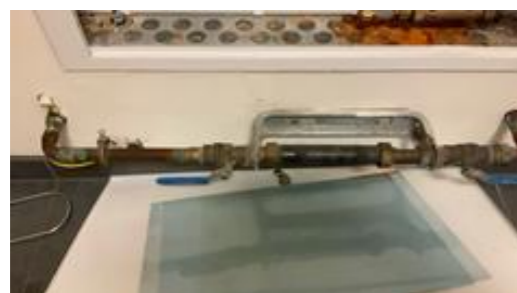
Stengekran på vann.
