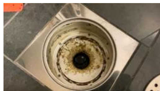
Sluk i gulv.
