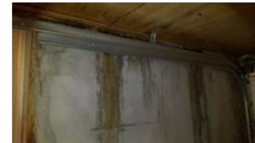
Eldre fuktrenner på mur i garasje.
