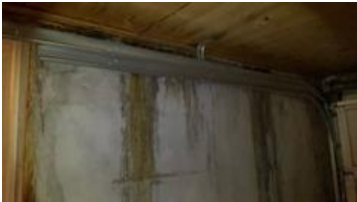
Eldre fuktrenner på mur i garasje.
