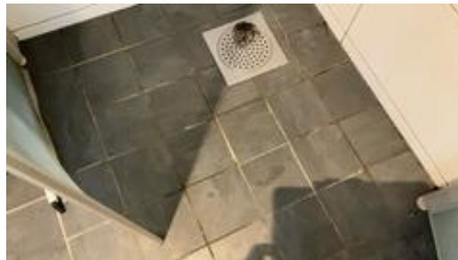
Misfarging/kalkmerker på overflater i dusj.
