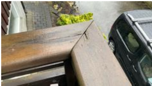
Oppsprikking av rekke.
