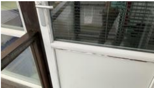
Malingsavflassing på overflater balkongdører.
