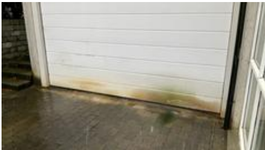
Misfarging/rustfarge på nedre del av garasjeport.
