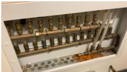
Vannledninger av plast
