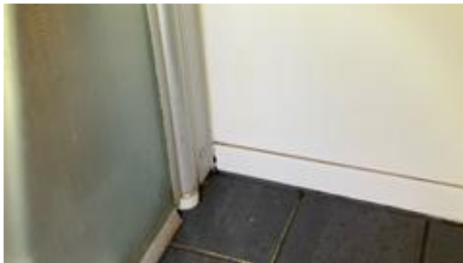
Misfarging i flisefuger, svertesopp på overflater.
