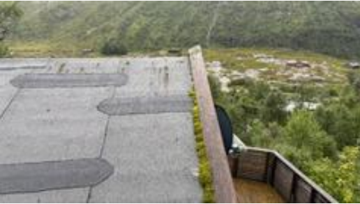
Mose og slitasje i vindskier/vannklaffer. Stedvise ilappinger.
