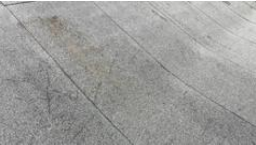
Synlig mekanisk påvirkning som kan være fra snømåking.
