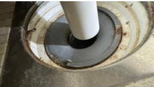
Rommet har to stk sluker i gulv. Begge mangler klemring, uten synlig membran ned i sluk. Avviket medfører usikkerhet mht. membran i gulv.
