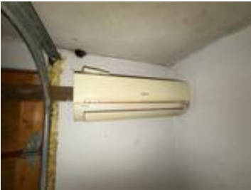
Defekt varmepumpe - kjeller
