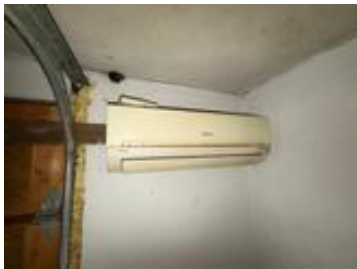
Defekt varmepumpe - kjeller
