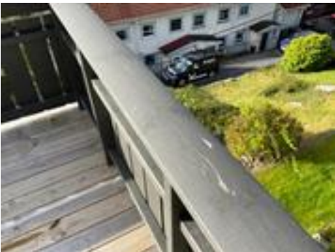
Slitasje på overflatebehandlingen.
