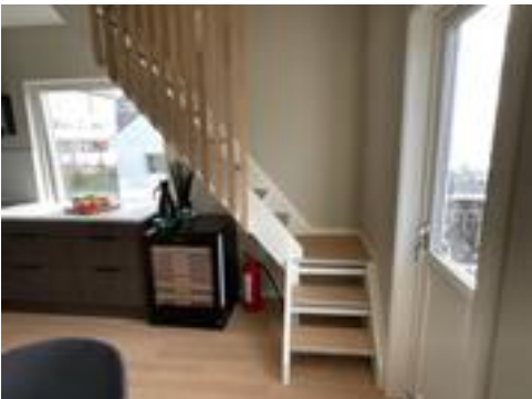
Trappen mangler håndløper.
