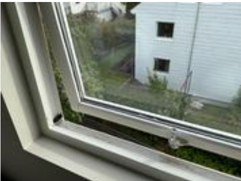
Værslitt vindu på soverom i loftet.
