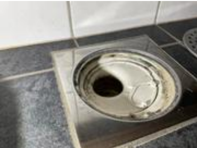
Sluk under baderomsinnredningen.
