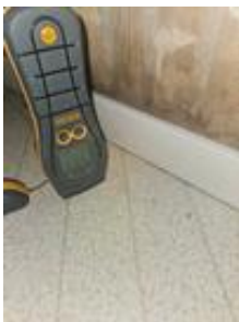
Høyt fuktinnhold i oppforet tregulv
