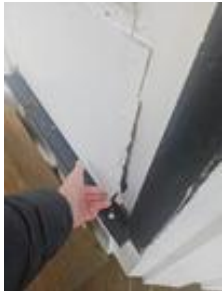
Verandadør sør. har vært reparert, men er nå utslitt
