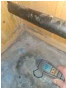
Høyt fuktinnhold i finplate gulv
