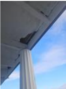
Fuktskader på trefiberplater under tekkingen
