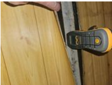
Høyt fuktinnhold i oppforet tregulv
