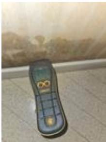
Høyt fuktinnhold i fremforet trevegg
