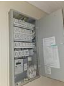
Sikringsskap med skrusikringer og kursfortegnelse
