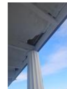
Fuktskader på trefiberplater under tekkingen
