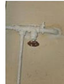
Stoppekran for vann. Må byttes.
