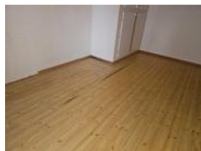
Tidligere kjøkken, kjeller. Gulvbelegget løsner og skjøten glipper
