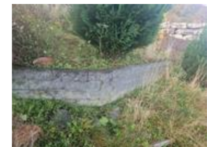
Støttemur av lettklinker i hagen har gitt etter for jordtrykk
