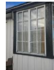
Vindu mot sør med råte på sprosser
