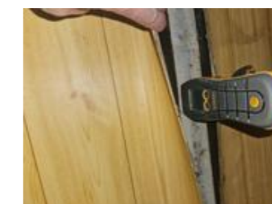
Høyt fuktnivå i oppforet tregulv
