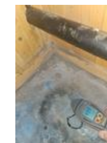
Høyt fuktnivå i finplate gulv
