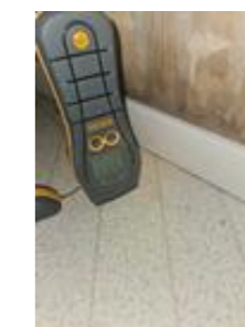
Høyt fuktnivå i oppforet tregulv
