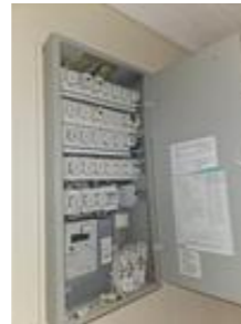
Sikringskap med skrusikringer og kursfortegnelse
