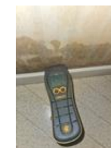
Høyt fuktnivå i fremforet trevegg
