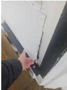
Verandadør sør. har vært reparert, men er nå utslitt
