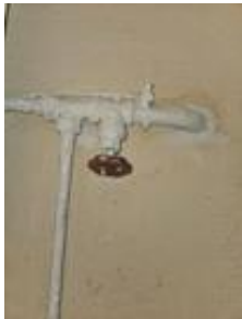
Stoppekran for vann. Må byttes.
