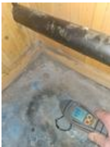
Høyt fuktinnhold i finplate gulv
