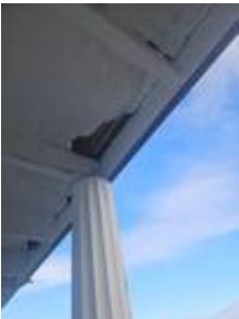
Fuktskader på trefiberplater under tekkingen
