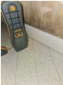
Høyt fuktinnhold i oppforet tregulv
