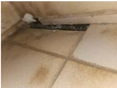
Sluken er vanskelig tilgjengelig
