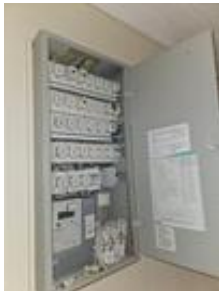
Sikringsskap med skrusikringer og kursfortegnelse
