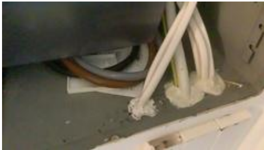
Det er kun fuget i gjennomføring i skapet.
