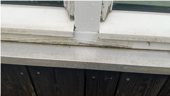
Slitasje i treverk.
