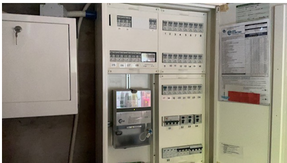
Sikringskap med automatsikringer.
