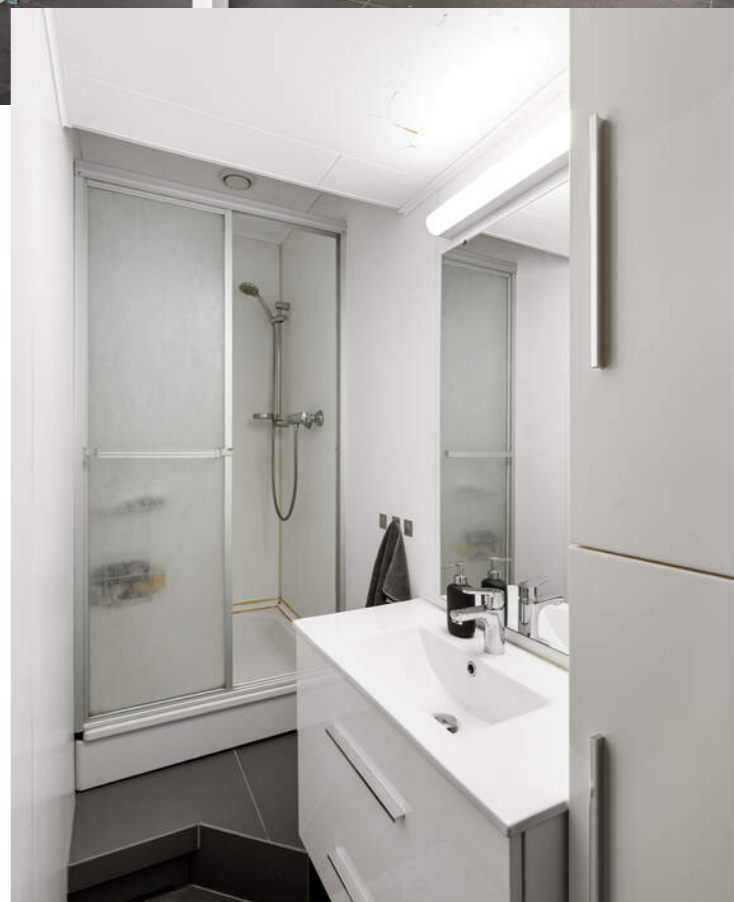
BADET INNEHOLDER TOALET, SERVANT OG DUSJNISJE.
