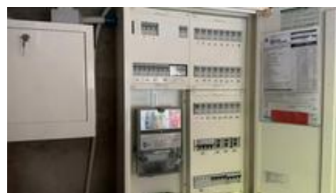
Sikringskap med automatsikringer.
