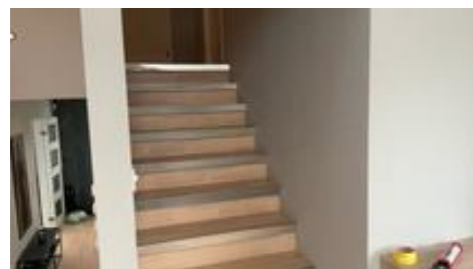
Innvendig trapp uten håndløper.
