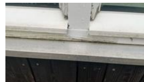
Slitasje i treverk.
