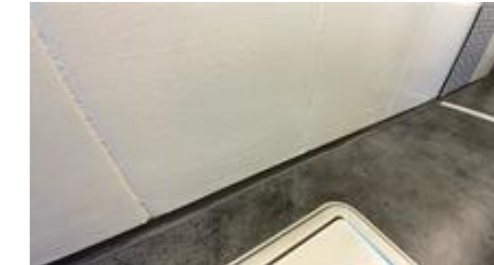
Fliser over kjøkkenbenk har struktur ujevnheter.
