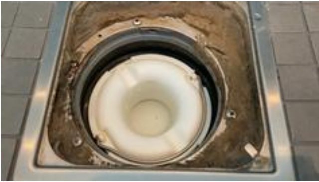
Plastsluk i dusjhjørnet.
