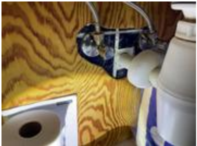
Ikke fuktette rørgjennomføring i vegg under vask.
