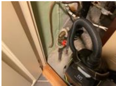
Stengekran på vann.
