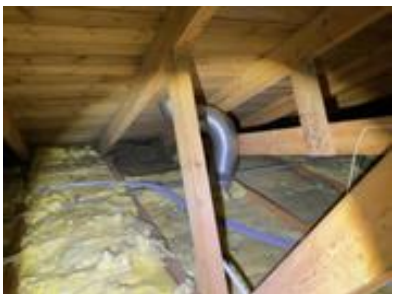
Uisolerte ventilasjonsrør på kaldtloft.
