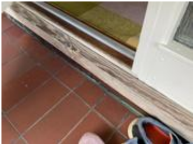
Ikke fagmessig/god belistning under hovedytterdør.
