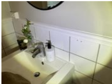
Borrede hull i fliser.
