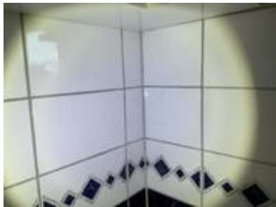
Sprikk i ett par veggfliser, her over hjørnekaret.
