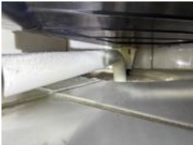
Sluk under dusjkabinett.
