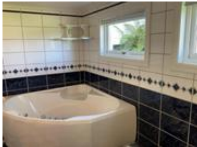
Vinduer plassert i badekarets fuktsone.
