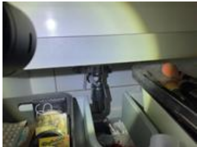
Ikke fukttette rørgjennomføring i vegg under vask.
