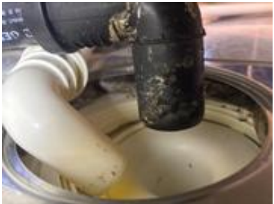
Sluk under dusjkabinett.
