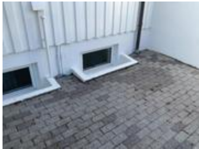
Deler av terreng med lite eler ingen fall fra mur.
