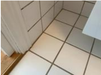
Bl.a område på gulv med bom/hulld under.
