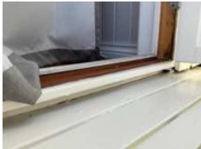
Ikke tilstrekkelig oppbrett/mangel av beslag under balkongdør.
