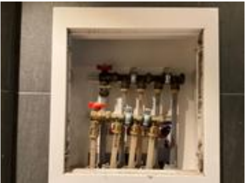
Rørskap på bad 2 etasje
