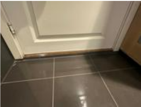
Lite til luft under dør.
