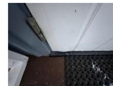
Svelle skader på ytterdør til 1 etasjen.
