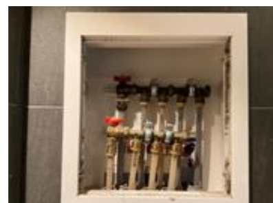
Rørskap på bad 2 etasje
