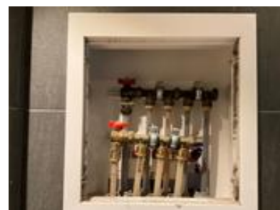
Rørskap på bad 2 etasje
