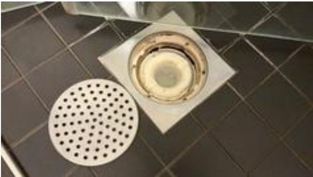
Plastsluk i gulv.
