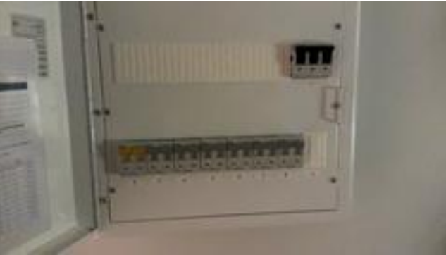
Sikringsskap med automatsikringer.
