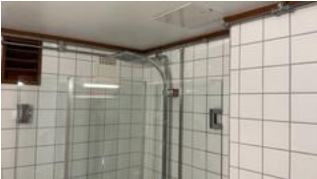
Utenpålagte forkrommede vannrør på badetrom.
