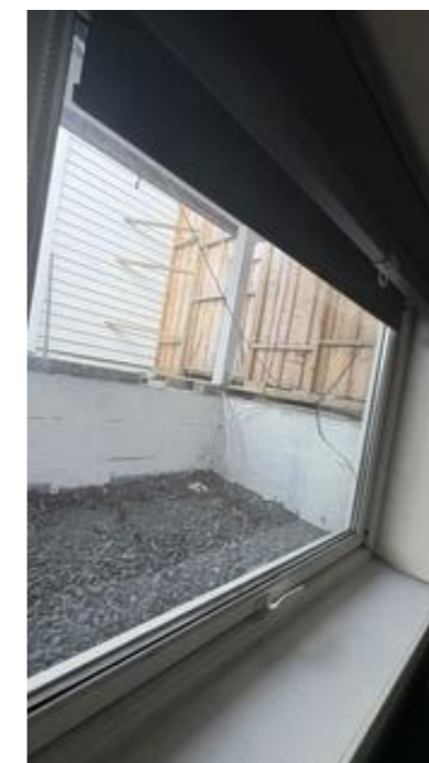
Bilder viser knust glass på soverom i kjelleren.
