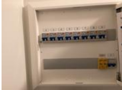
Bilde av sikringskap
