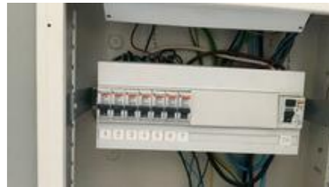
Sikringskap med automatsikringer.
