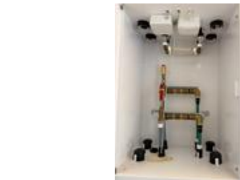
Rørskap i vegg på bad v/soverom.
