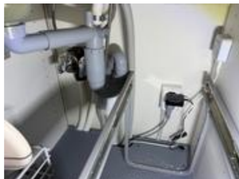
Rørapplegg i kjøkkenbenk
