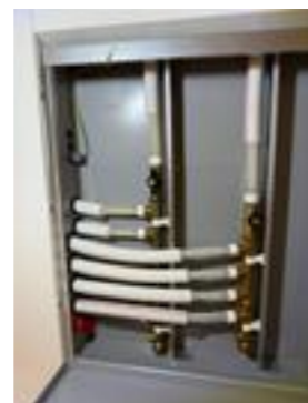
Rørskap i himling på bad v/entre.
