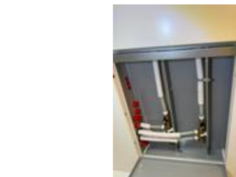
Rørskap i himling på bad v/soverom.
