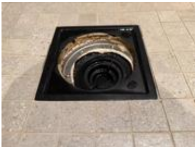
Plastsluk i dusjsone.
