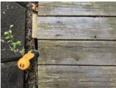
Lokal råte i terrassebord.
