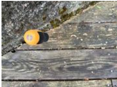
Lokal råte i terrassebord.
