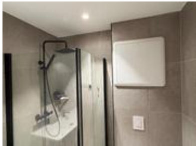
Rør i rør skap i våtsone.
