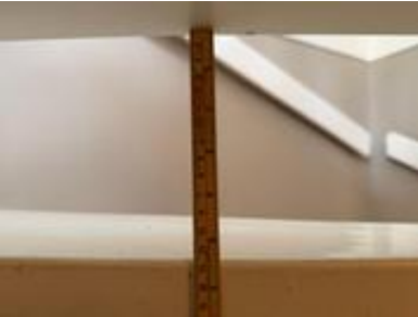
Åpninger mellom trinnene er større enn 10 cm. Barnesikringslist bør monteres. Avvik registrert i HMS punkt.
