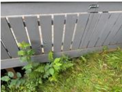
Manglende trinn på utside av port. Avvik registrert i HMS punkt.
