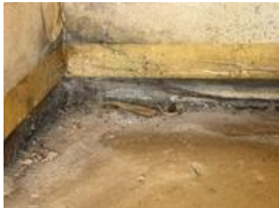
Fukt og misfarging i nedre del av konstruksjonen i bod i bakkant.
