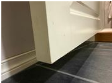
Fuktutsvelling/slitasje i nedre del av badedør.
