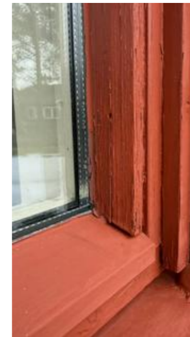
Eksempelbilde av slitasjegrad/ malingsavlass på vindu fra opprinnelig byggeår.
