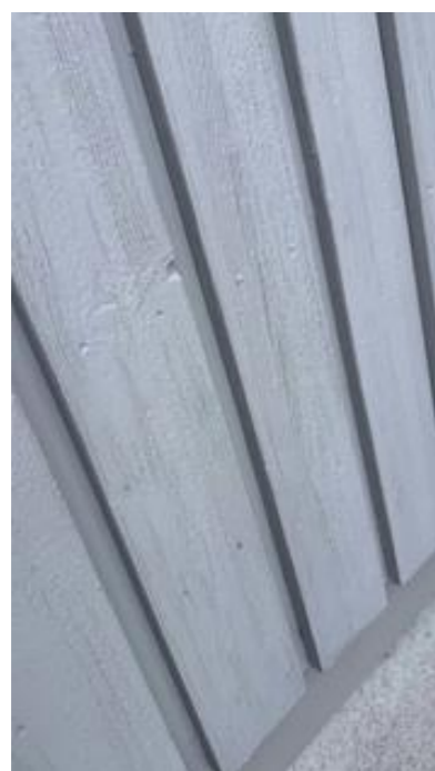
Eksempelbilde av stedvis malingsavflass/værslitasje.
