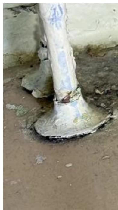
Eksempelbilde av ikke tilfredsstillende tetting rundt rørføring i gulv.
