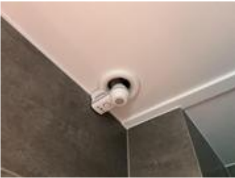
Avtrekksvifte på badet
