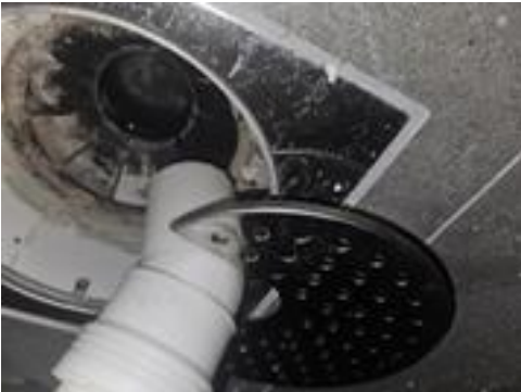
Plastsluk med slukmansjett og klemring, under badekaret
