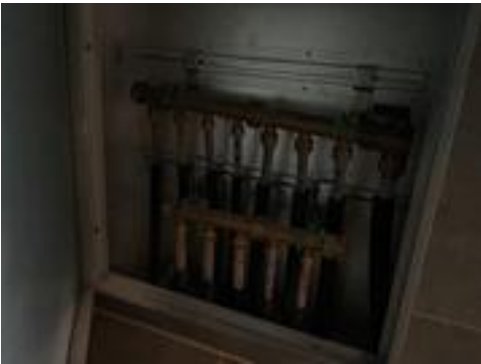
Fordelingsskap for tappevann. Stoppekran i skapet.
