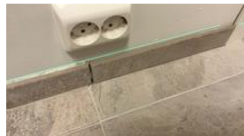
Mangler fuge rundt flis.
