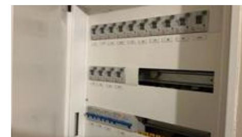
Sikringskap med automatsikringer.
