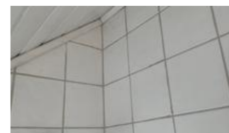
Oppsprekk i hjørne fuge av sement
