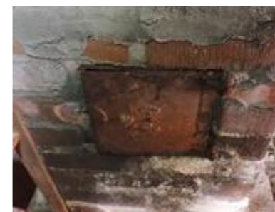
Sotluke på pipe til stue 1
