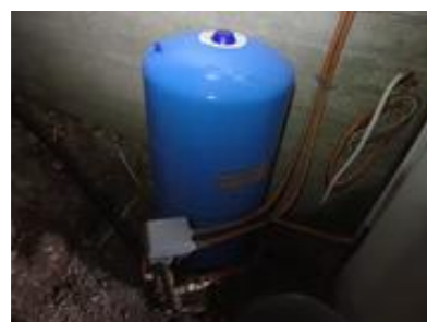
Akkumulatortank og stoppekrane i kjeller.
