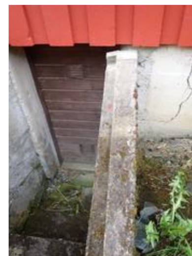
Løs innfesting av mur til kjellernedgang.
