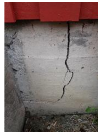
Spekk i mur ved kjellernedgang.
